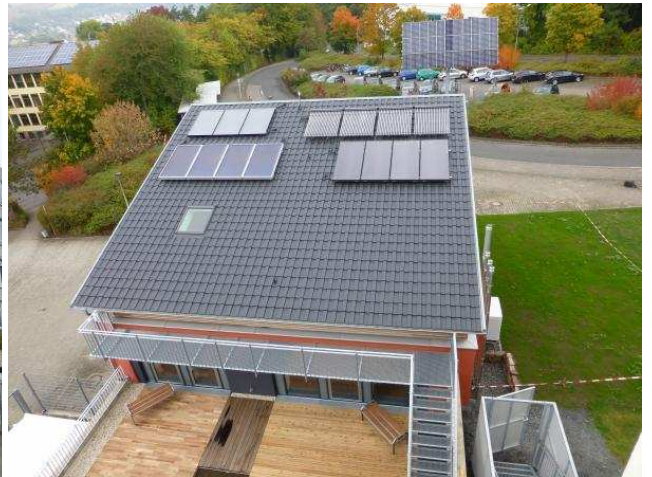
Solarthermie auf dem Dach mit Solartankstelle hinten
